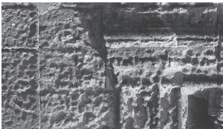
Fig. 52 Dégradation de la pierre.
