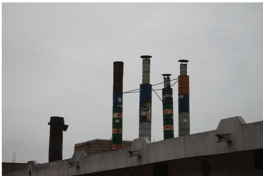
Cheminées faites de matériaux de récupération
