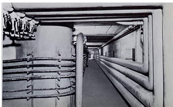
Tunnel de liaison pour câbles électriques et chauffage
