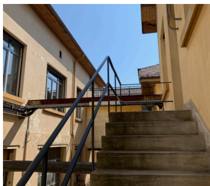
Electricité entre bâtiments
