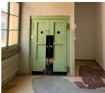
Ascenseur et mauvais état du sol
