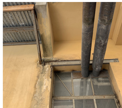
Tuyauterie sur fenêtre
