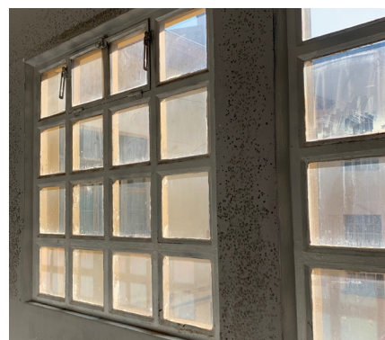
Fenêtre et infiltrations d'eau
