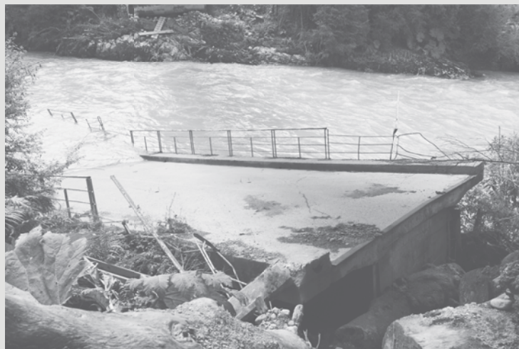
Pont effondré secteur Qeulat
