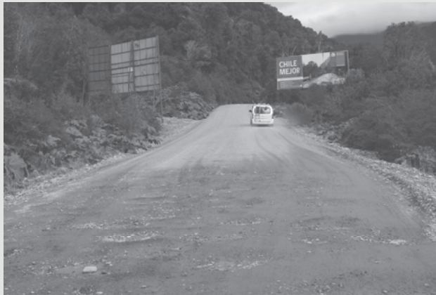
Ornières et panneaux “informatifs”
