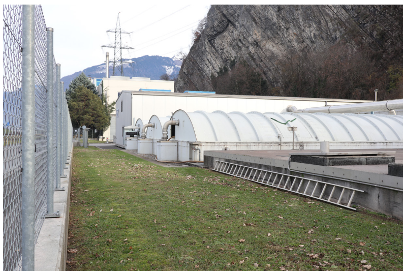
Figure 53. Bassins de décantation à l'exté- rieur, mais couverts
