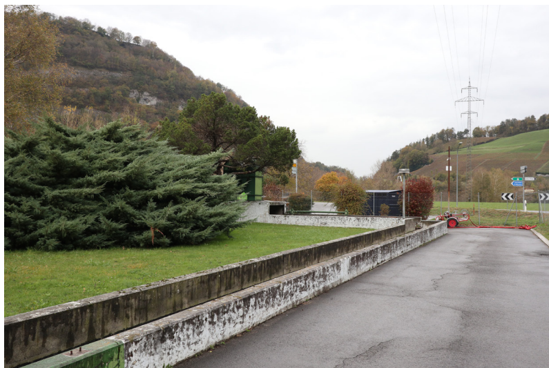
Figure 30. Canal extérieur alimentant les bassins
