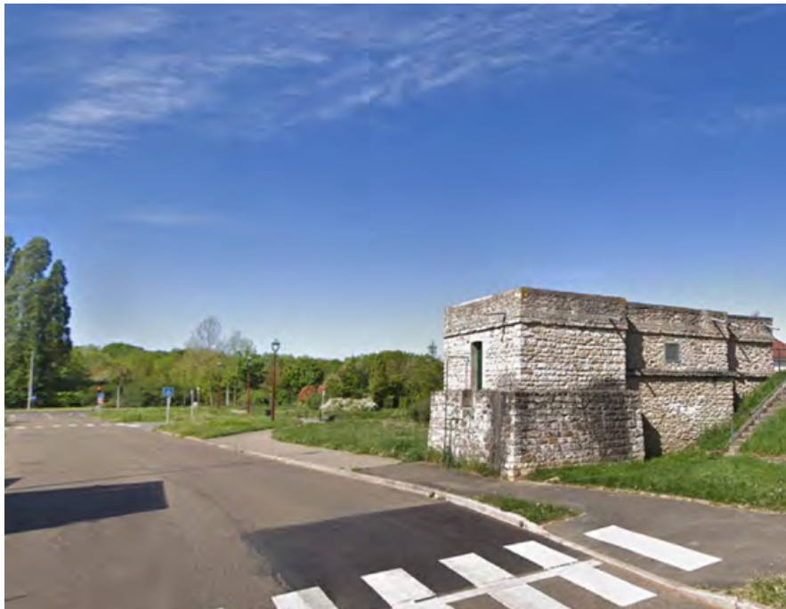
Vue sur une tête de siphon
