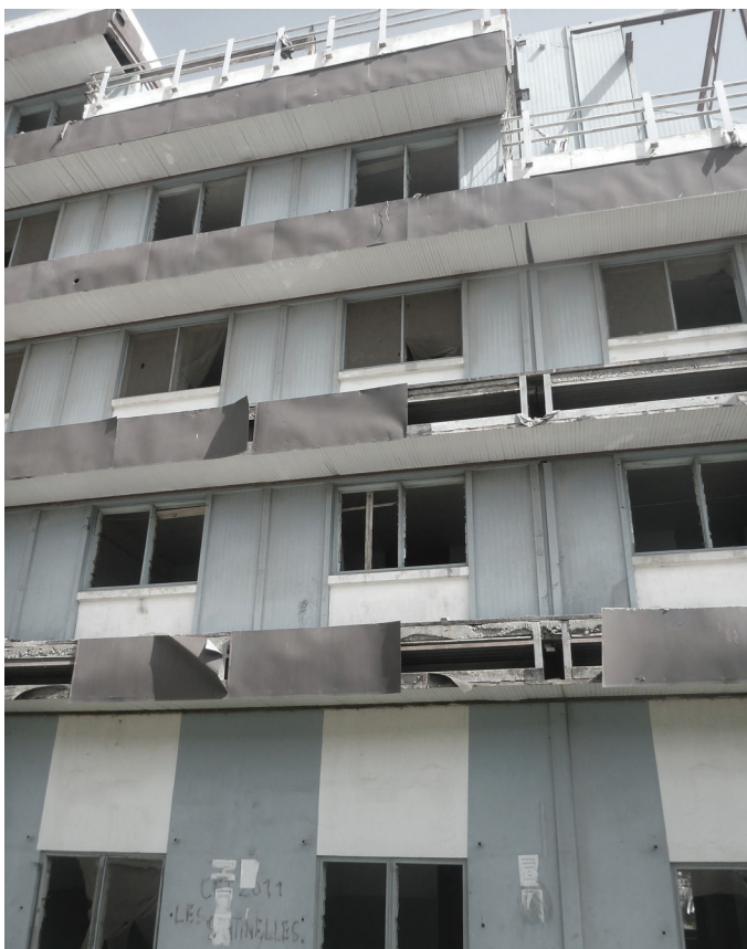
pavillon N dégradation du revêtement
