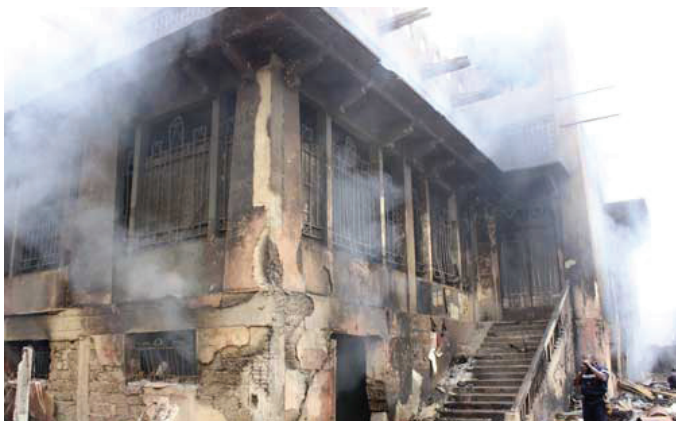
dégâts du feu
