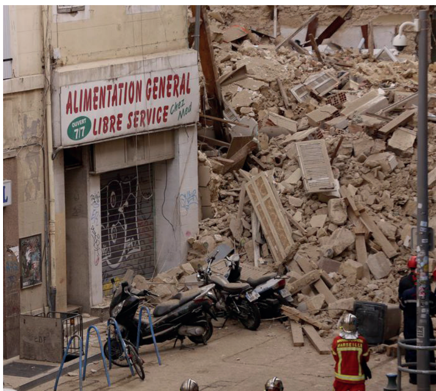
Fig. 2 Effondrement rue d'Aubagne, le 5 novembre 2018 Source: La Provence
