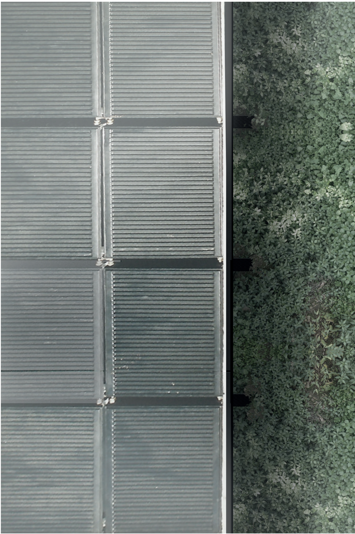
Toiture verte extensive, équipée de panneaux thermiques réalisés progressivement par le centre, en détournant p.e. d'anciens panneaux radiants ou éléments de frigo
