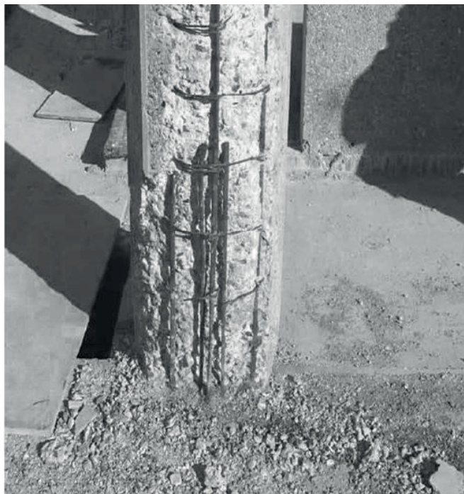
Fig.159- ISAI Le Havre Colonne octogonale du rez-de-chaussée en mauvaise état.
