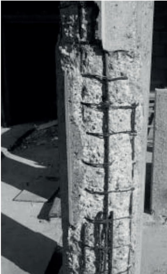
Fig.119 -Détail de la colonne octogonale dans les îlots ISAI. Dans le bon état et une colonne dégradé à cause du carbonisation du béton. Chaque granulat cache une vérité constructive derrière.
