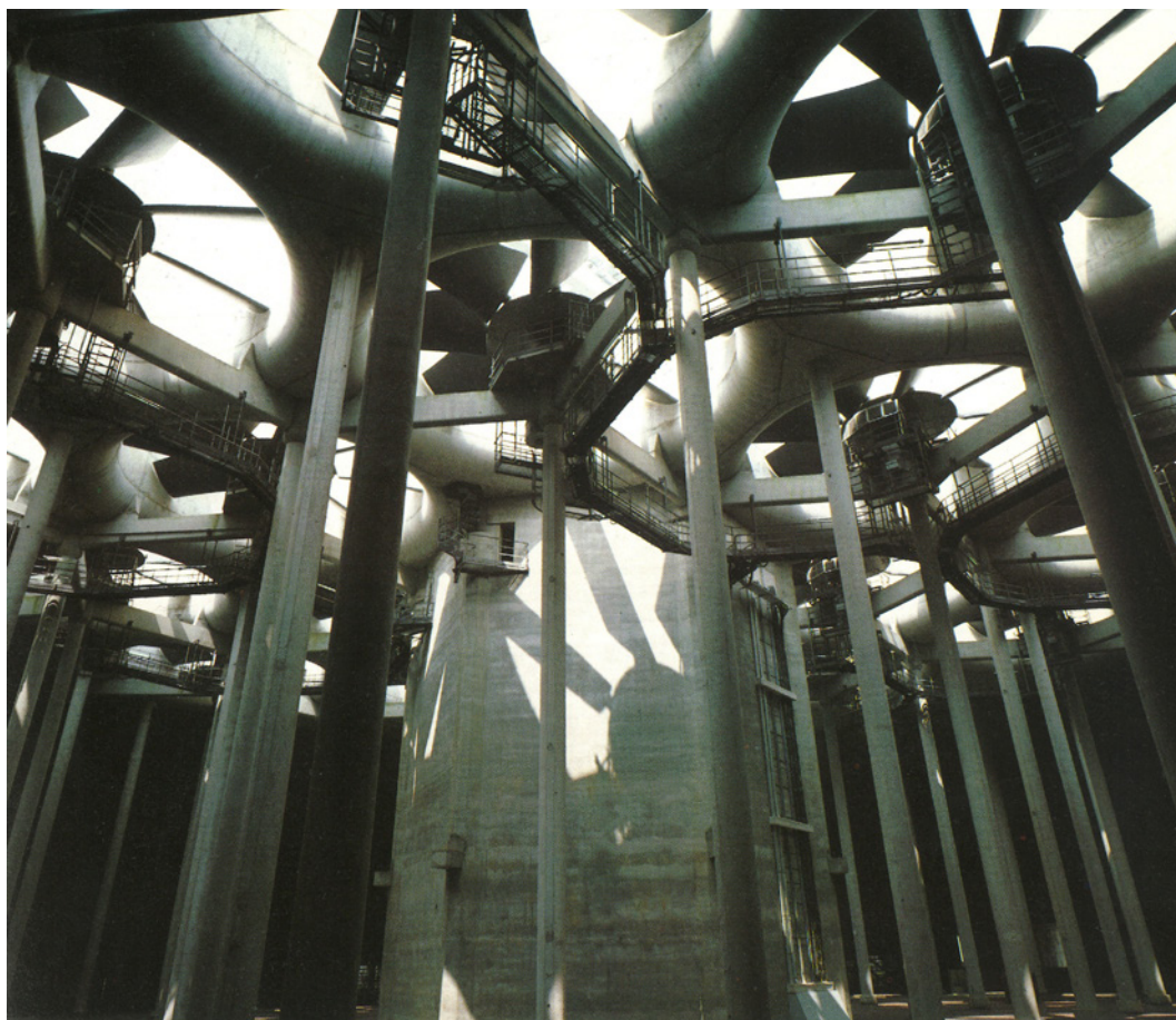
fig s. Les superbes espaces intérieurs des refroidisseurs à tirage induit
