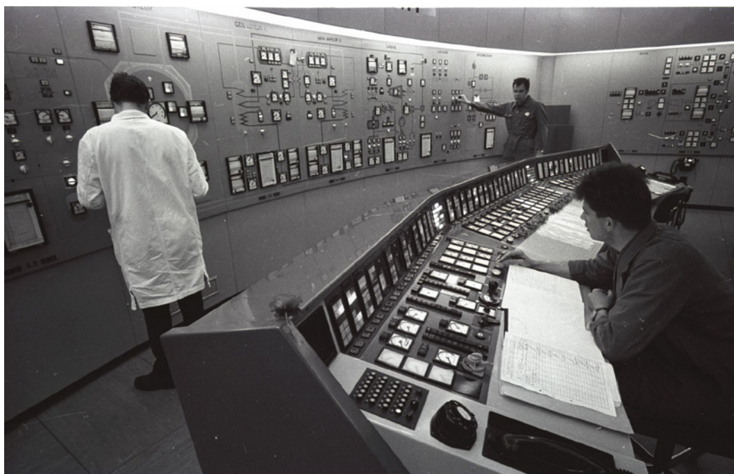
fig j. Salle de commandes de la centrale de Lucens, les salles de commandes des centrales en activité diffèrent peu de celle-ci.
