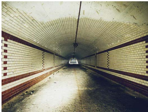
Fig. 7 Partie du plafond bétonnée suite au bombardement.
