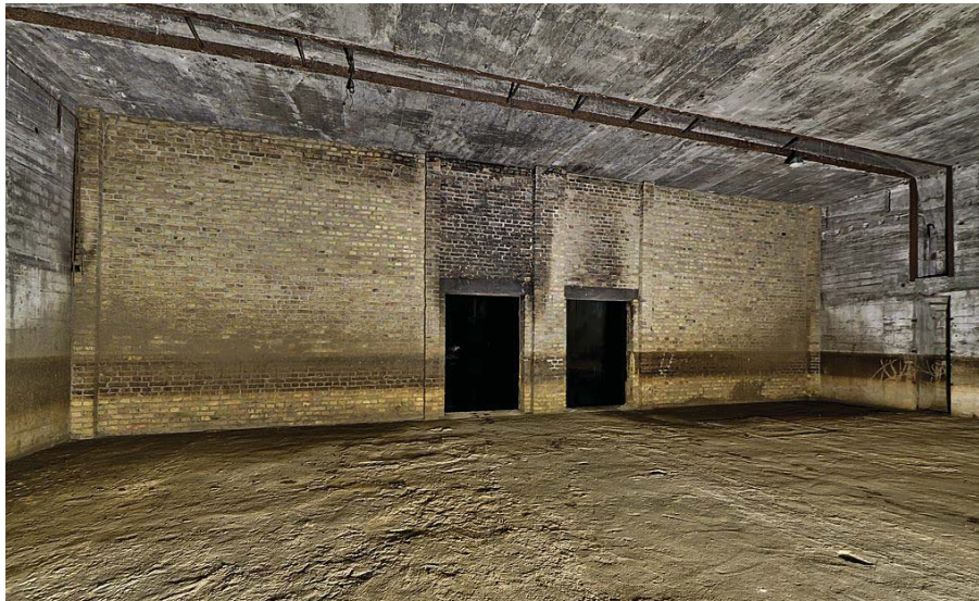
Fig. 43 Tunnel Ouest, obstrué par un mur en brique.
