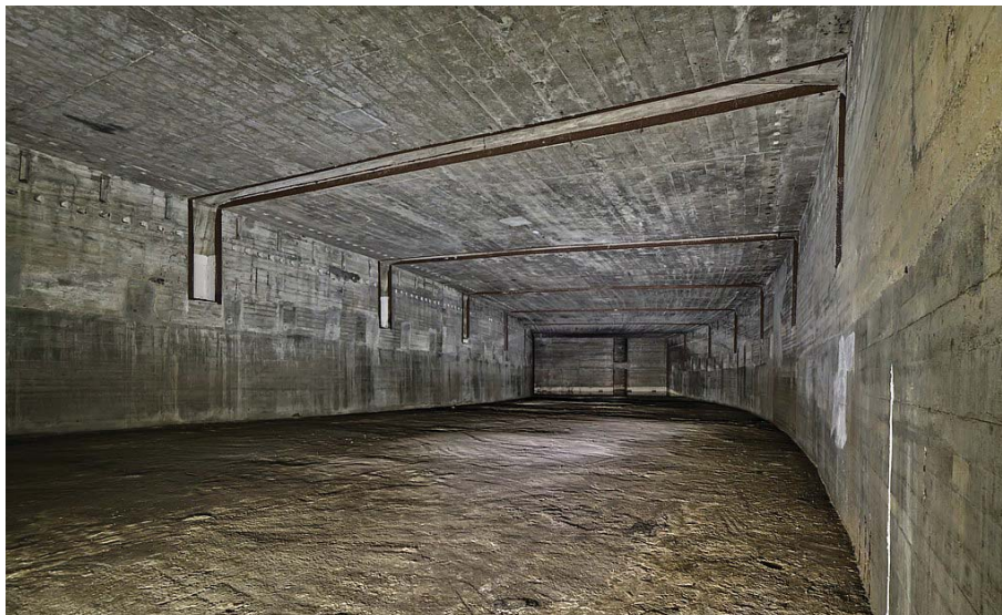
Fig. 40 Tunnel Est se obstruée par un mur en béton.
