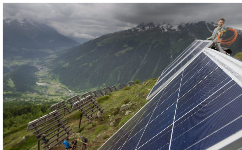
Fig.33 | Centrale solaire de Bellwald
