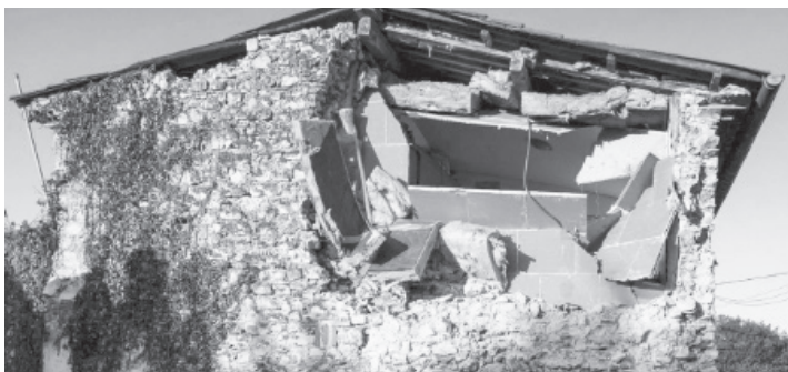
[1.6] Constat et analyse des dégâts - Quartier Rouvière, Le Teil, France
