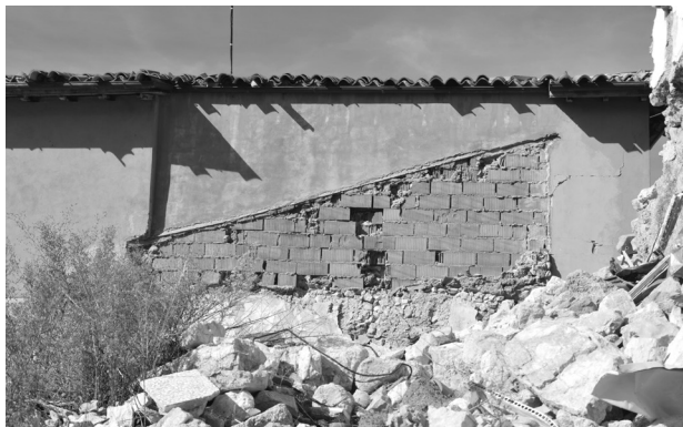
[1.21] Maison à San Pellegrino, Umbria, Italia - Dégât structurel visible en façade
