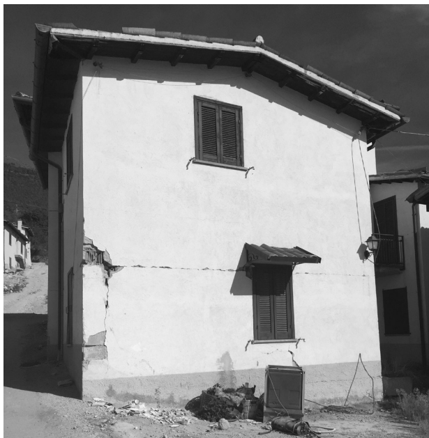
[1.16] Maison à San Pellegrino, Umbria, Italia - Dégât structurel visible en façade
