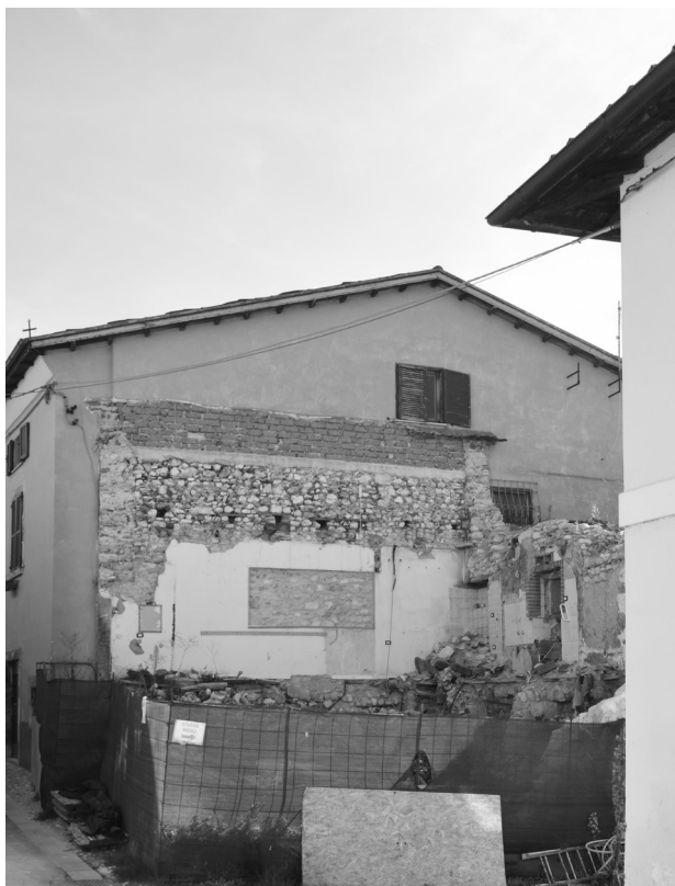
[1.22] Maison à Norcia, Umbria, Italia - Dégâts sur la façade
