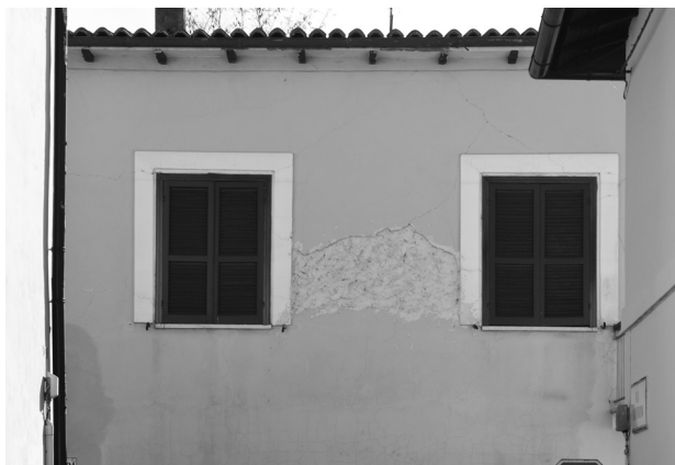
[1.17] Maison à Norcia, Umbria, Italia - Dégâts sur la façade
